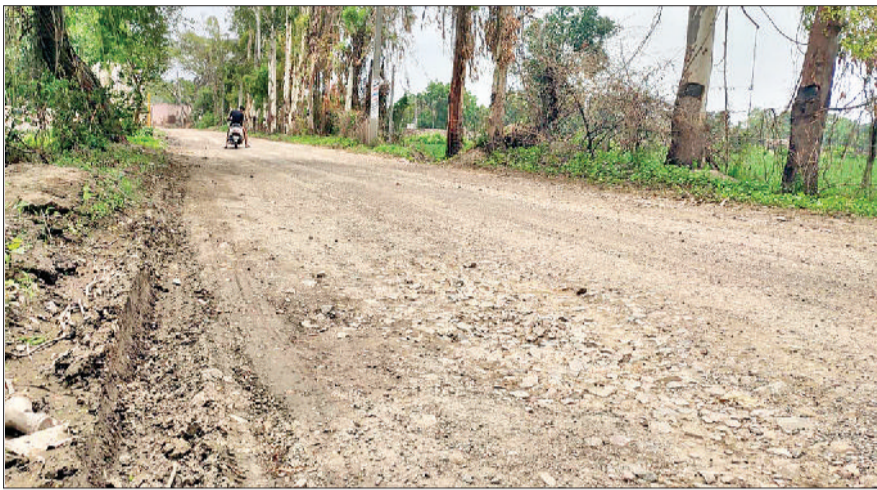
गन्नौर। बुरी तरह से क्षतिग्रस्त अवस्था में पड़ा सनपेड़ा रोड।
